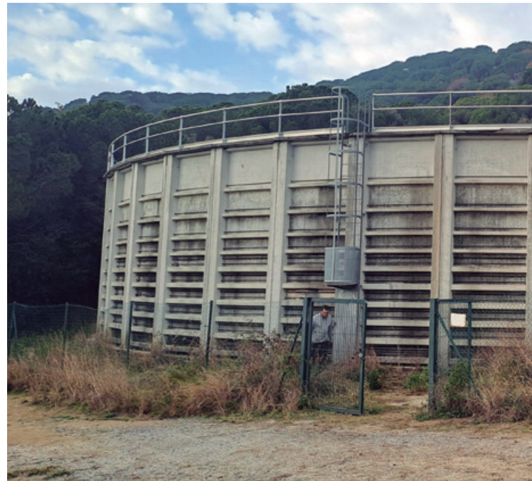
Dipòsit de capçalera de 6.000 m 3 del Rocar d'en Serra (març de 2024).
