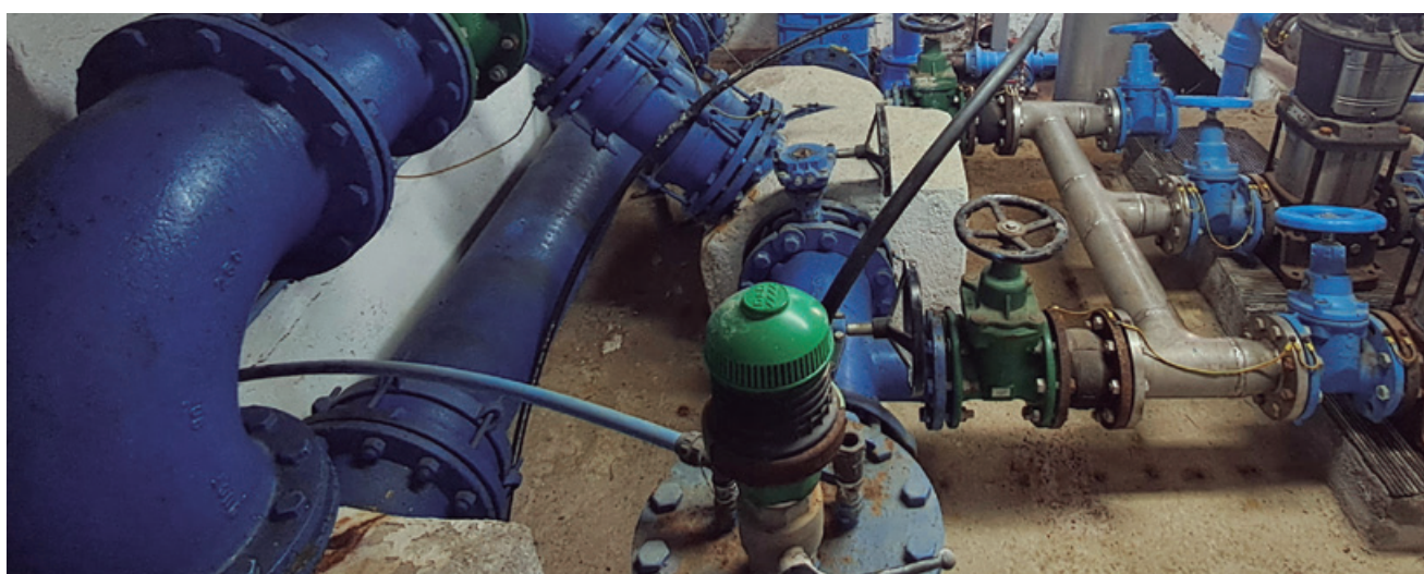
Sala de màquines del dipòsit de la Pedrera de 2.000 m 3 (març de 2024).
