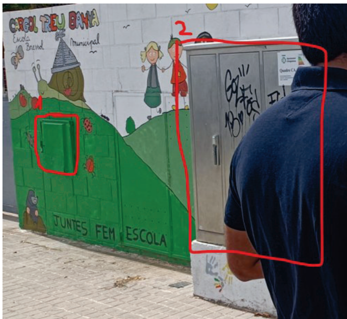
Fotografía actual: 1) CDM 2) quadre i comptador enllumenat públic
