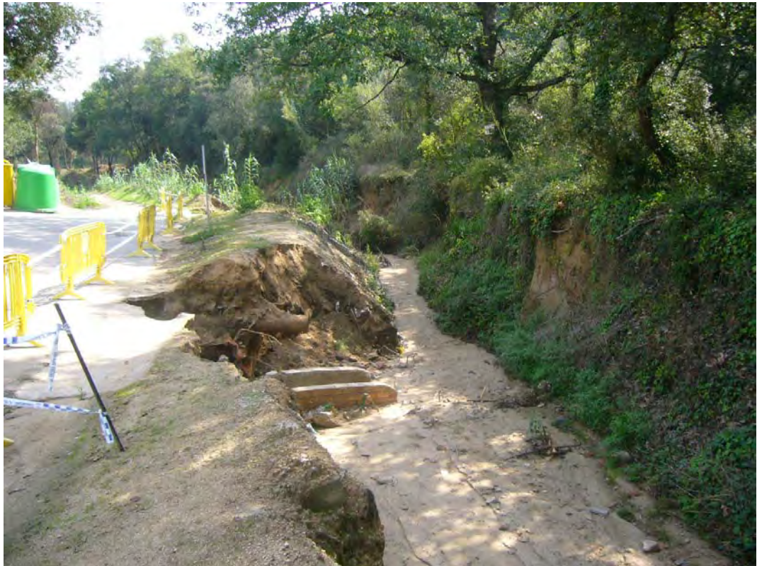
Fotografia 3.- Efectes dels aiguats al final del passeig al costat del camp de futbol
