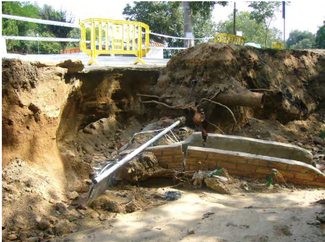
Fotografia 4.- Efectes dels aiguats al final del passeig al costat del camp de futbol
