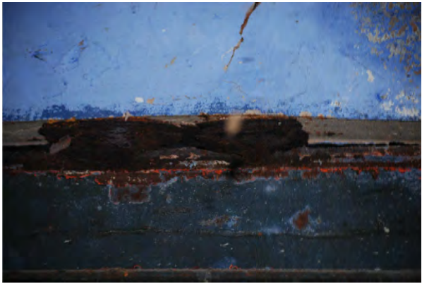
Imatge 4. BODEGA. Planta soterrani Exfoliació de perfil de ferro al oxidar-se per excés d'humitat.
