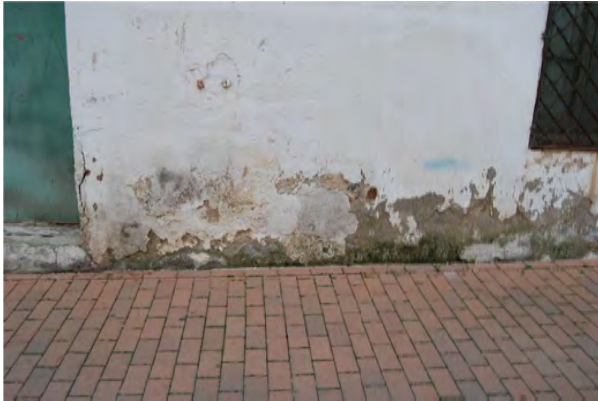
Imatge 10. EXTERIOR. Degradació per humitats de capilaritat. Reparacions amb morters de portland.
