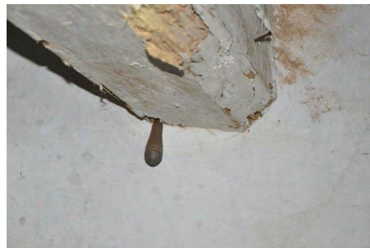
Pèrdua de secció en recolzament. Estat crític
