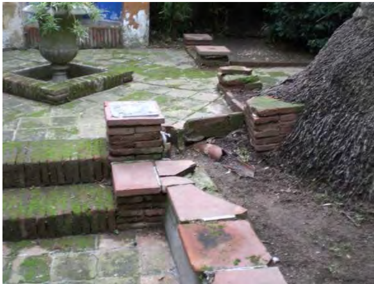
Imatge 20 Estat del paviment i murets del jardí (II)
