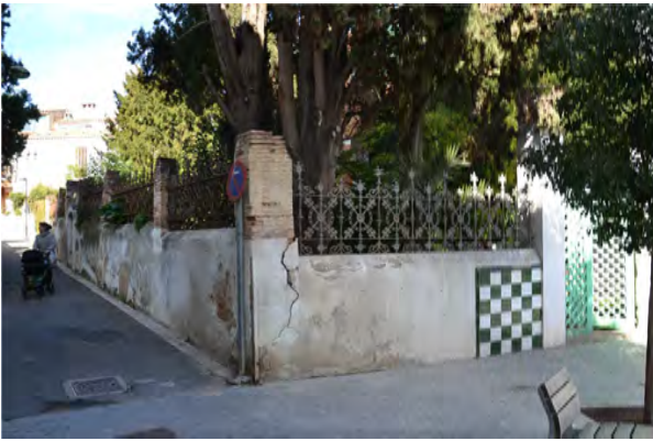
Imatge 11. EXTERIOR. Esquerda provocada per empenta de les arrels.
