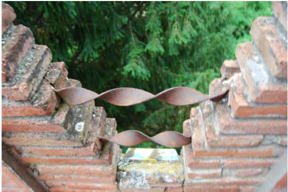
Imatge 15. EXTERIOR-TERRASSA. Planta segona Aument de volum de ferro oxidat i trencament d'elements d'obra.
