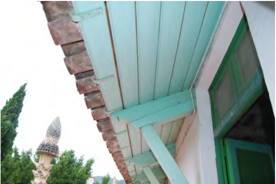
Imatge 14. EXTERIOR-TERRASSA. Planta segona Encadellat de fusta separat per lliscament de coberta
