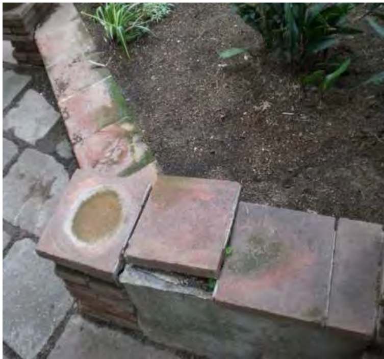
Imatge 19 Estat del paviment i murets del jardí (II)
