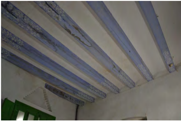
Imatge 2. HABITACIÓ D'EN PUIG I CADAFAALCH. Pl. primera Presència d'humitat afectació a les bigues de fusta
