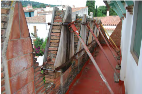
Imatge 12. EXTERIOR-TERRASSA. Planta segona Apuntalament de marlets per manca d'estabilitat pel seu grau d'esveltesa.
