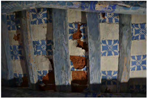
Imatge 1. DESPATX D'EN PUIG I CADAFAALCH. Planta baixa Desgradació de la peça ceràmica per humitat excessiva i afectació a estructura portant
