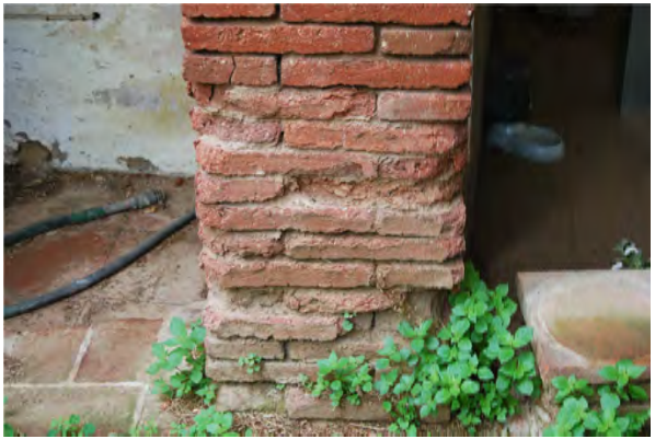
Imatge 11. EXTERIOR. Pèrdua de material per humitat de capilaritat.
