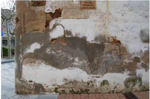
Imatge 9. EXTERIOR. Degradació per humitats de capilaritat. Reparacions amb morters de portland.
